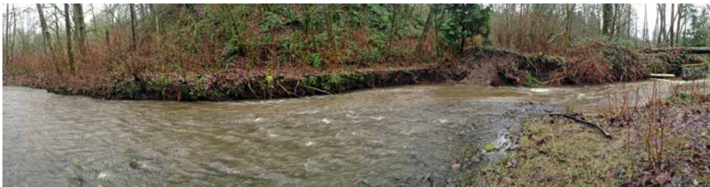
Защитная насыпь канализационного коллектора Коул Крик размывалась в результате разливов реки
